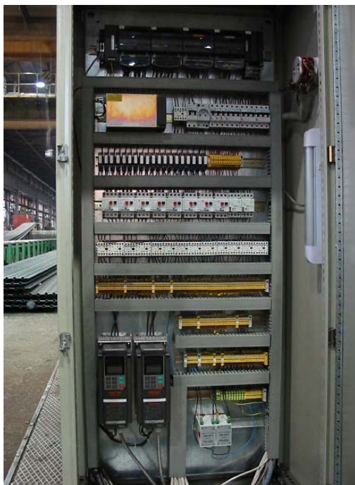
Rys. 1 Szafa sterownicza automatu
