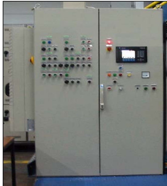
Rys.5 Wtapiarka Anod – Szafa PLC (Rittal TS8)
